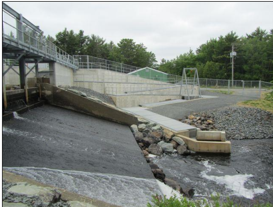
Figure 6. Installations de passage du poisson au barrage du lac Hebb dans la Petite Rivière.
